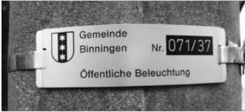
Die Strassenlampen sind gekennzeichnet: Die Nummer 071 steht in diesem Beispiel für Margarethenstrasse, 37 für Kandelaber Nr. 37.
