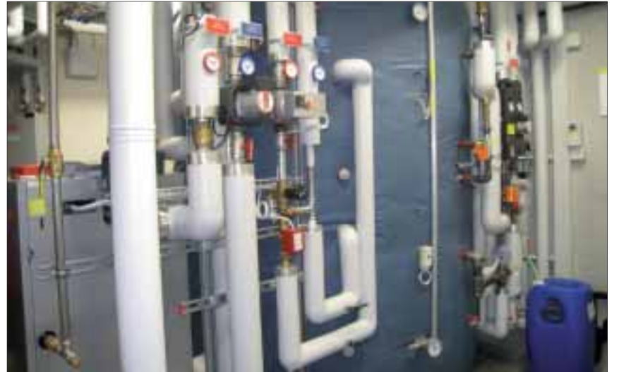
Warmwasseraufbereitungsanlage mit Speicherkessel.
